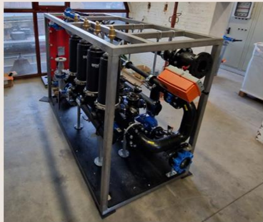
Fijnfiltratie (in skid)
